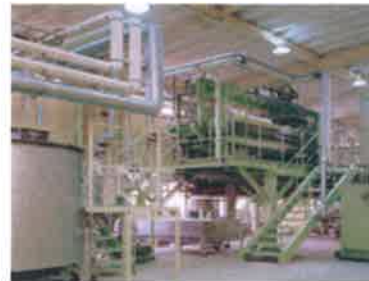
自社のエキス製造設備
